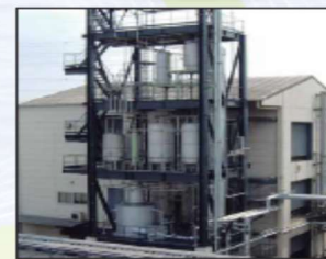
使用済液の回収設備
